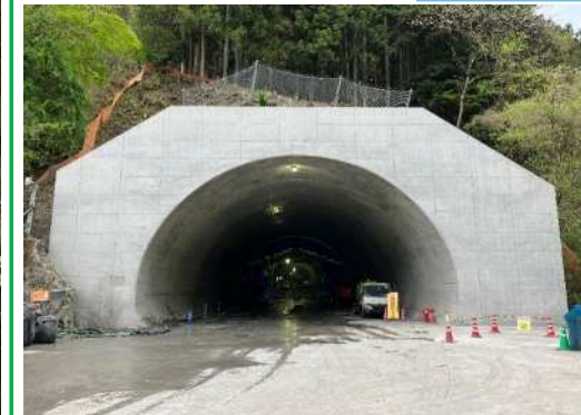
起点側坑門コンクリートの打設が完了しました。コンクリート裏の埋戻しが終われば完了となります。
