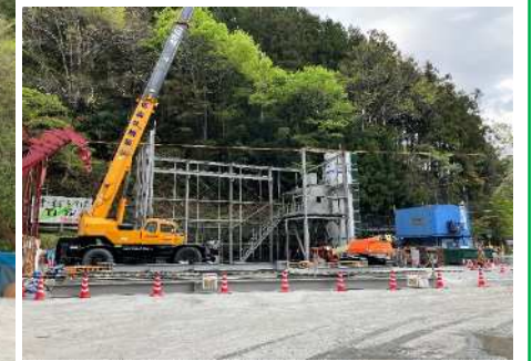
吹付けコンクリートを練っていたバッチャープラントも役目を終え解体しました。ちょっと寂しい感じです。
